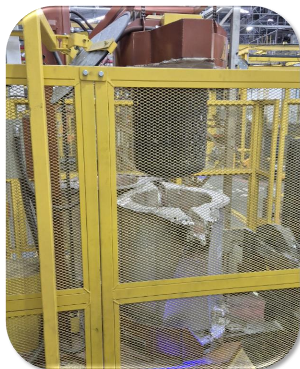
Aquecedor de painéis elétrico da Injeção de Alumínio
