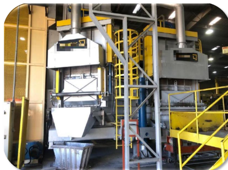
Central de fusão da fábrica de Linhares.
