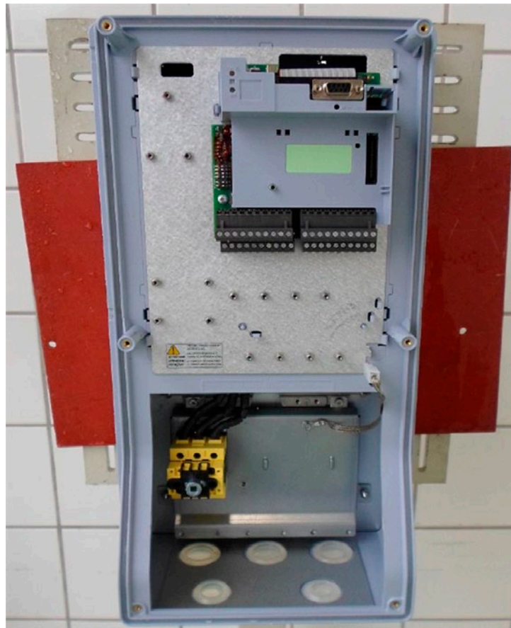
Lado interno de la muestra 01 luego de la prueba de entrada de agua; placa de control y entrada
