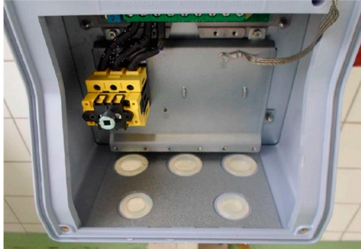
Lado interno de la muestra 01 luego de la prueba de entrada de agua; llave seccionadora de entrada
