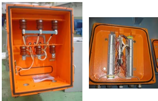
Figura 3: Caixas de ligação
