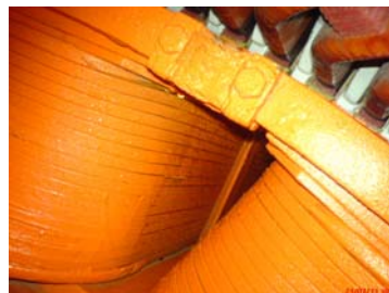
Figura 26: Umidade nos enrolamentos
