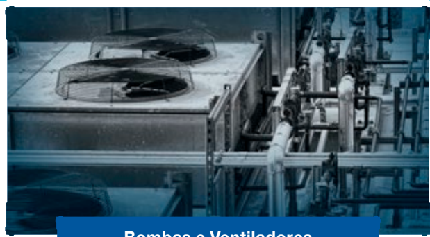
Bombas e Ventiladores
