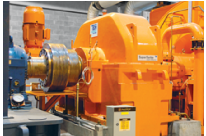
CERRADINHO - Chapadão do Céu, GO - Brazil / Turbogenerator - 45 MW SuperTurbo - ST 710
