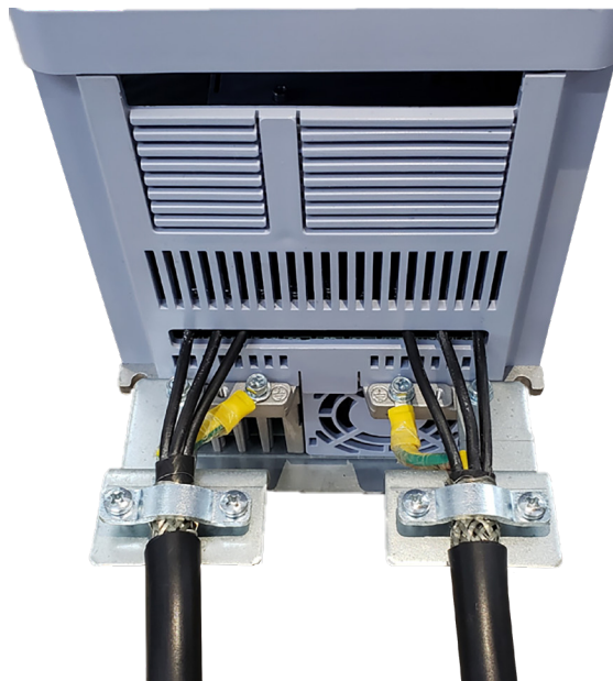
Figura 3.28: Detalle de la conexión de la blindaje de los cables de potencia
