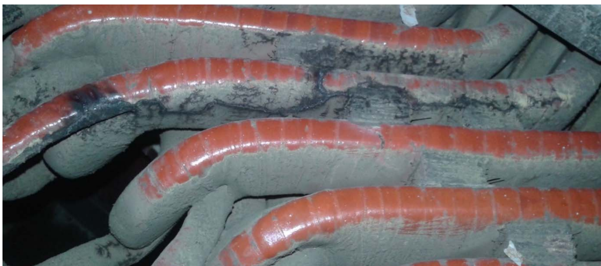
Figura 2: Trilhamento na superfície da isolamento contaminada
