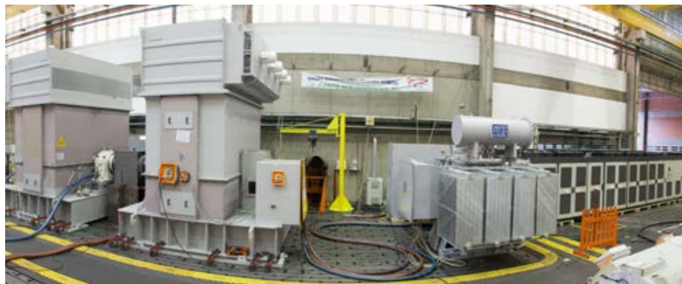
组合测试（中压输入开关柜 + 移相变压器 + 中压变频器 + 中压电机）。
