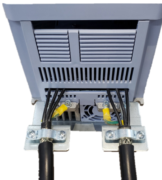
Rysunek 3.28: Szczegóły dotyczące podłączenia ekranu kabla zasilającego
