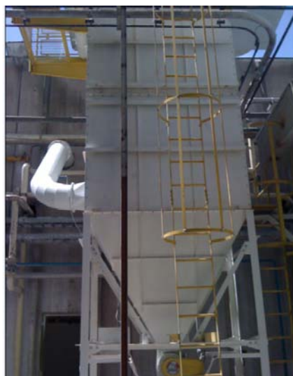
Foto I – Sistema de Exaustão - Filtro de Mangas
