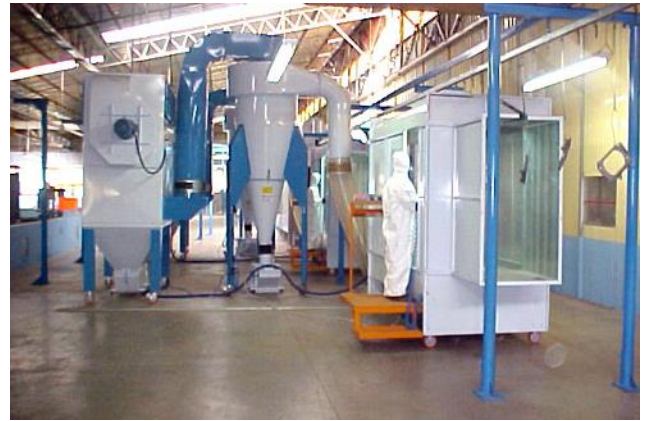
Figura 40: Cabine de pintura, linha contínua com recuperação tipo ciclone ligado ao filtro manga
