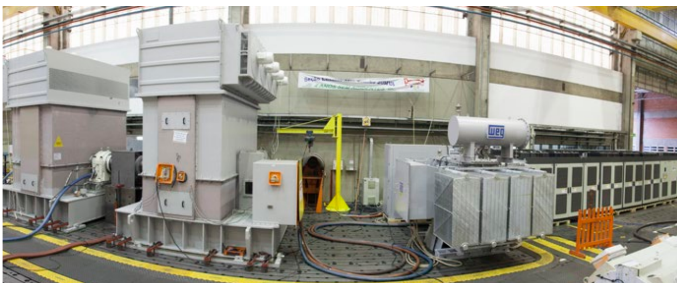
Teste combinado (conjunto de manobra de entrada MT + transformador defasador + inversor de frequência MT + motor MT).
