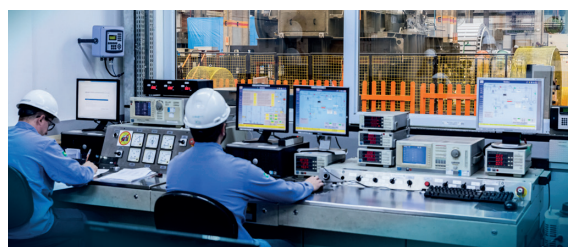
Sala de controle do laboratório de ensaios de 20 MVA
