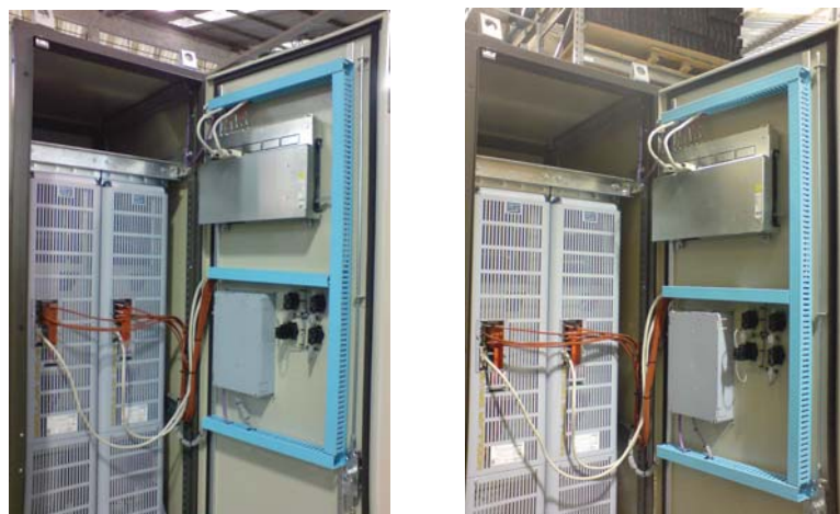
Figura 26 - Detalhe dos cabos de controle e da placa de interface (IPS1)
