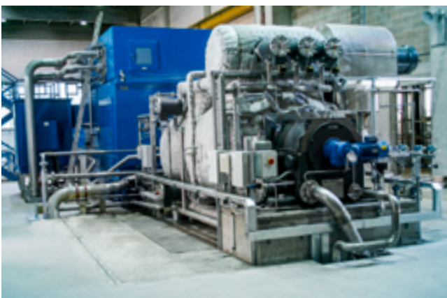
Instalación en piso superior con base civil, escape radial hacia abajo y generador de cuatro polos.
