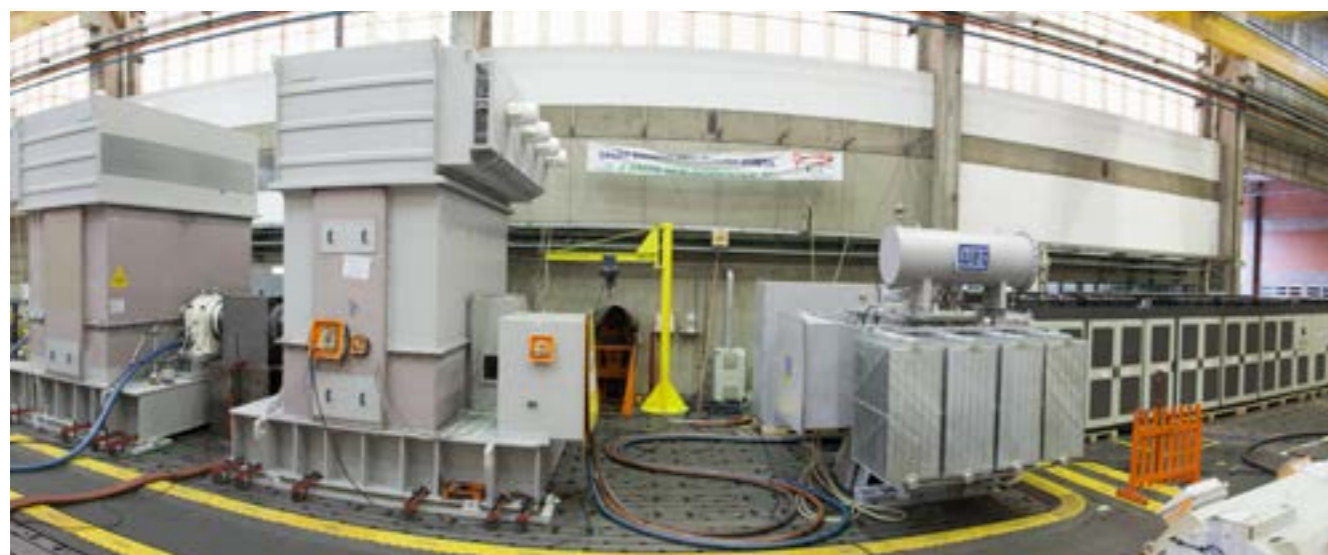
组合测试（中压输入开关柜 + 移相变压器 + 中压变频器 + 中压电机）。
