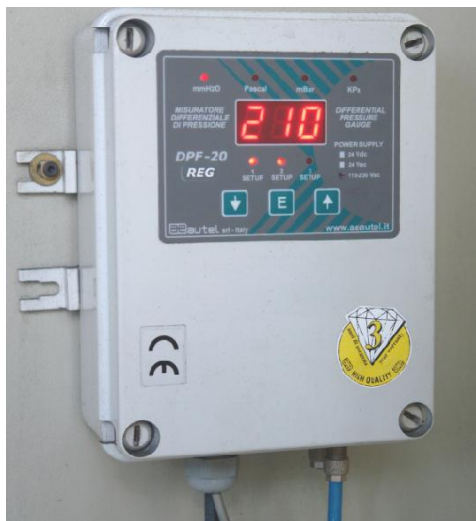
Foto V - Transmissor de Pressão
