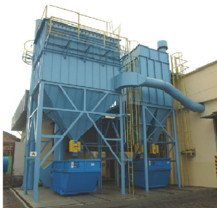
Foto I - Sistema de Exaustão
