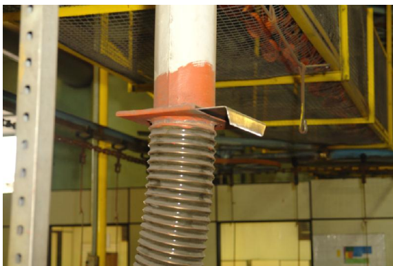
Foto VI - “Damper” do tubo de captação
