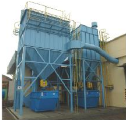
Sistema de Exaustão
