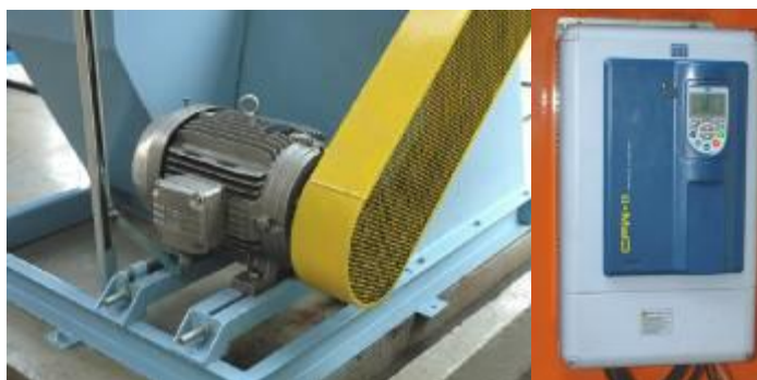
Motor de Imãs Permanentes com Inversor de Frequência
