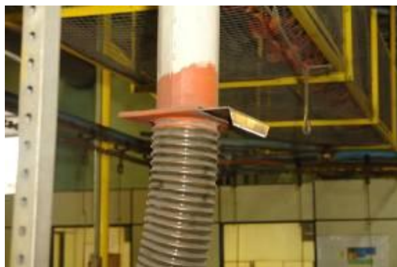
“Damper” do tubo de captação
