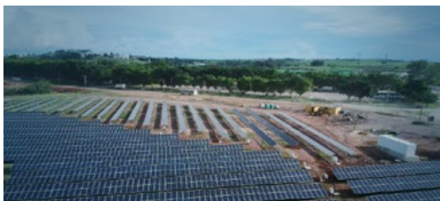
UFV RAÍZEN - 1.267,00 kWp
