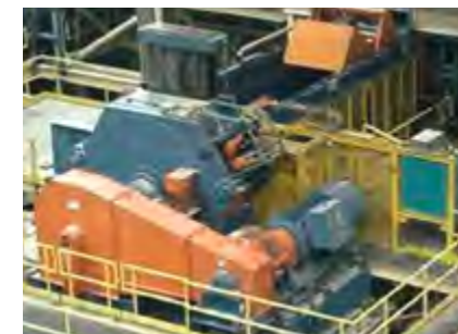
Suministro: 600HP, 4160V, 4 polos Aplicación: Desfibrador de Madera Canadá - Industria Papel y Celulosa
