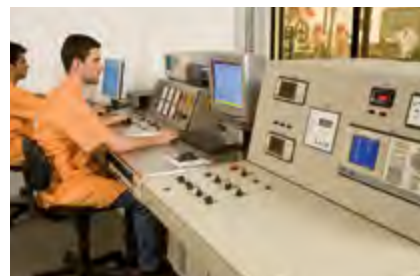
Sala de comando
