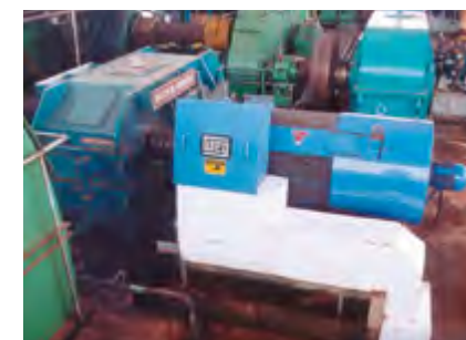
Suministro: 1,250HP, 480V, 6 polos Aplicación: Accionamiento de mollienda México - Ingenios
