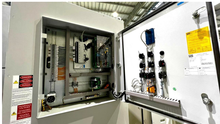
Figura 5.17: Compartimento de baixa tensão (exemplo mecânica 10/11 kV)
