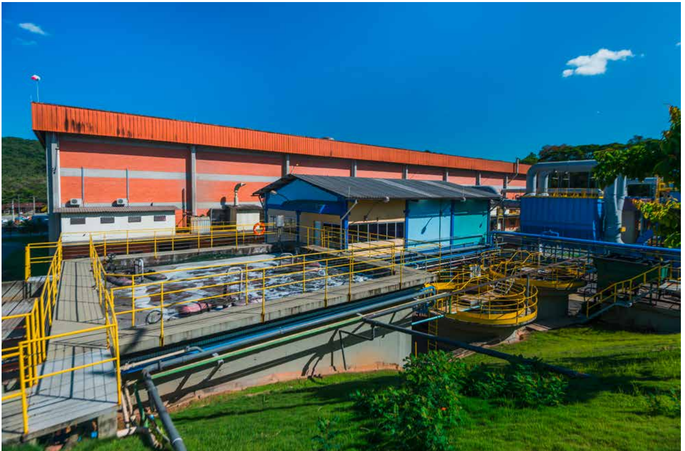
ETE - Estação de Tratamento de Efluentes
