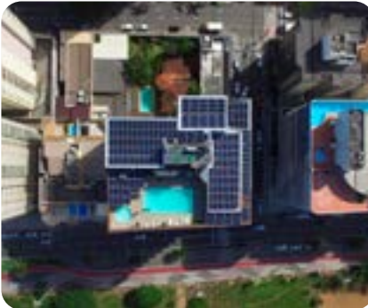
Generador fotovoltaico en condominio de 90 kWp - ES
