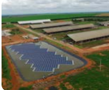
Generador fotovoltaico rural con estructura fluctuante de 1,01 MWp - MG
