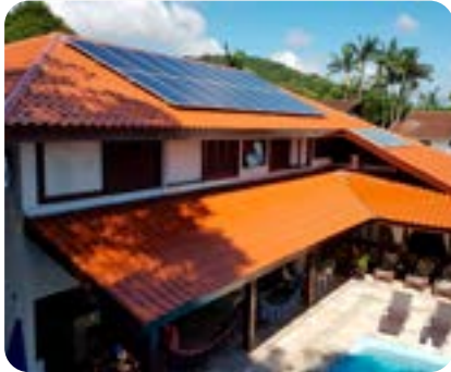
Generador fotovoltaico residencial de 6,12 kWp - SC
