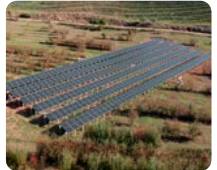
Generador fotovoltaico para suelo de 132 kWp - RS
