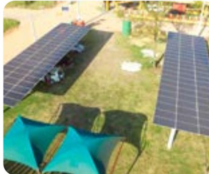
Generador fotovoltaico para garaje de 40 kWp - ES
