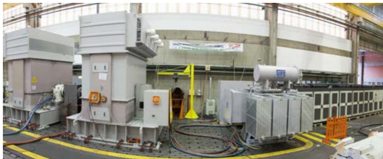
组合测试（中压输入开关柜 + 移相变压器 + 中压 VSD + 中压电机）。
