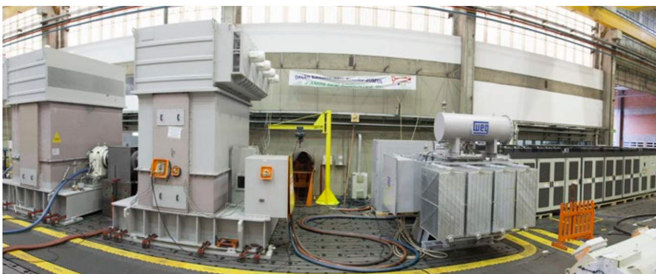
Teste combinado (Conjunto de Manobra de Entrada MT + Transformador Defasador + Inversor MT + Motor MT).
