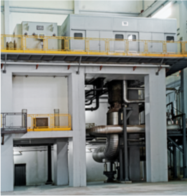
Instalação em piso superior com base civil, escape radial para baixo e gerador de quatro polos.
