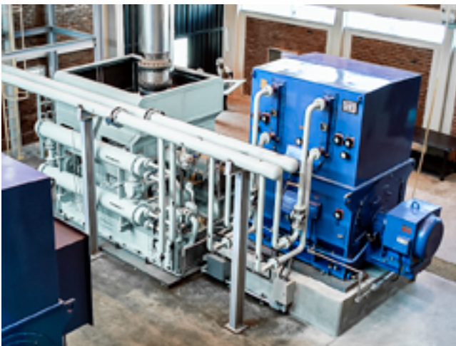
Instalação em piso inferior com base metálica, escape radial para cima e gerador de quatro polos.
