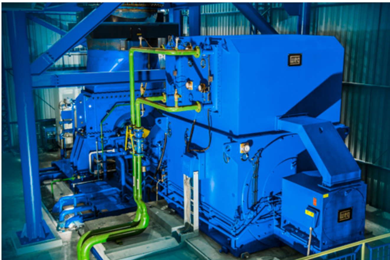
Instalação em piso inferior com base metálica, escape radial para cima e gerador de dois polos.
