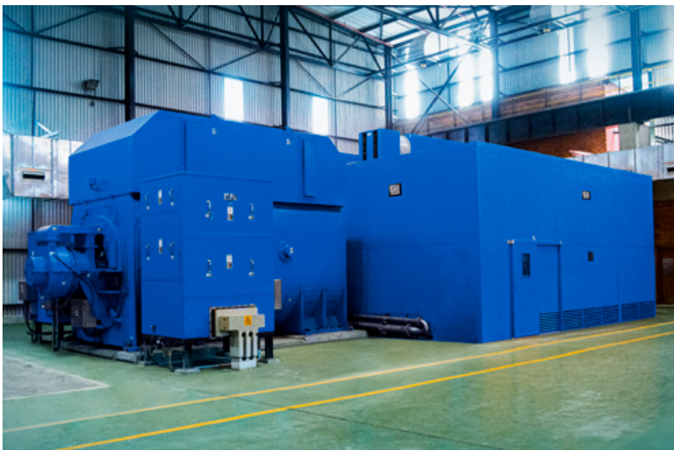
Instalação em piso superior com base civil, escape radial para baixo e gerador de dois polos.
