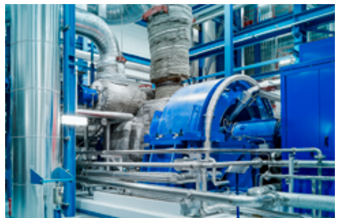
Instalação em piso superior com base civil, escape radial para baixo e gerador de dois polos.
