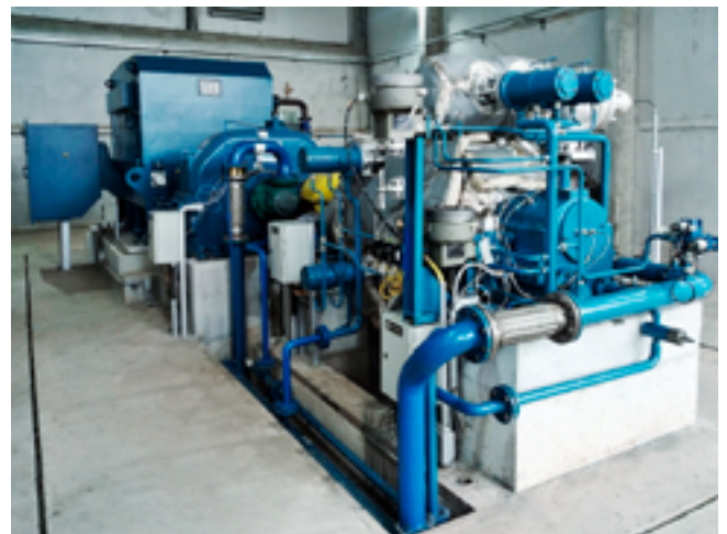
Instalação em piso superior com base civil, escape radial para baixo e gerador de quatro polos.
