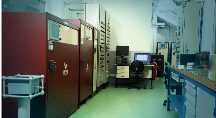
Sala de controle - Laboratório de Sistemas de Isolação
