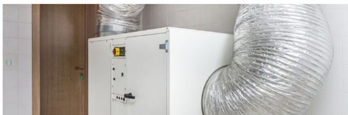
Controladores de Aire
