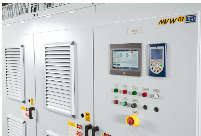
Figura 4.1: HMI para o inversor MVW01
