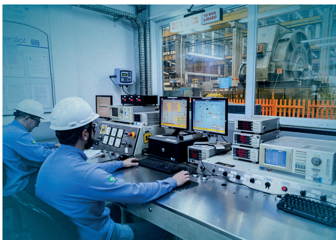
Sala de controle
