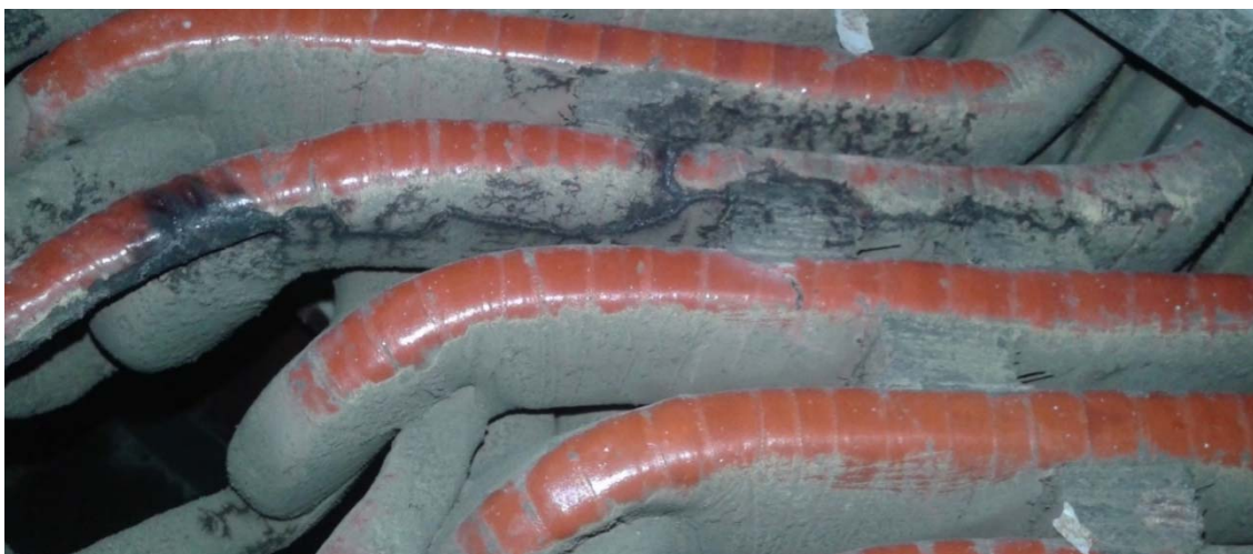
Figura 2: Seguimiento de la superficie de aislamiento contaminada
