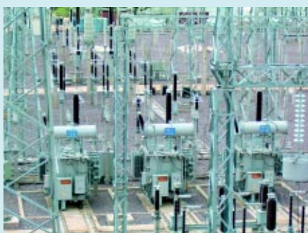
← Transformadores WEG em Angola
