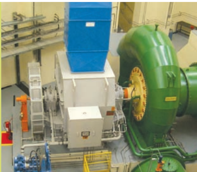
Gerador WEG instalado na PCH Santa Laura
