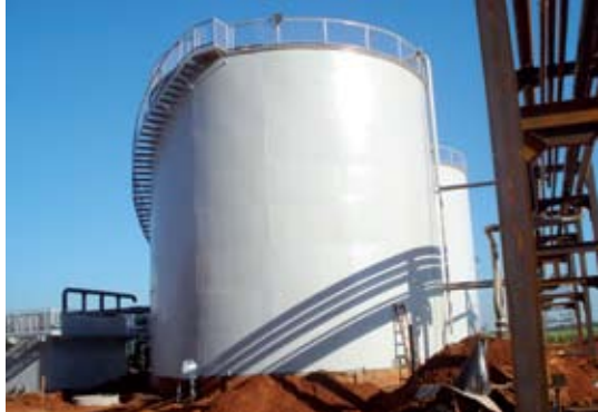
Tanques de álcool da Usina Caeté usam WEGTHANE 508 Antifungo
